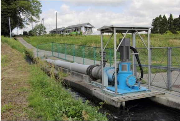
図 5-4 農業水路に設置された小規模水力発電の例
