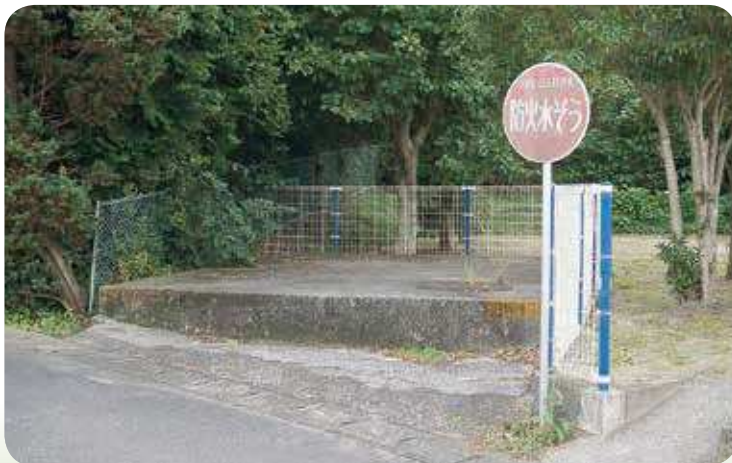
年1回点検している防火水槽
