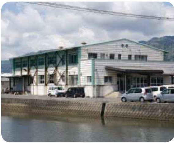
老朽化した給食センター
