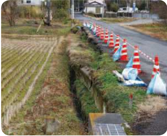
水路まで崩れ落ちた路肩（南大神）
