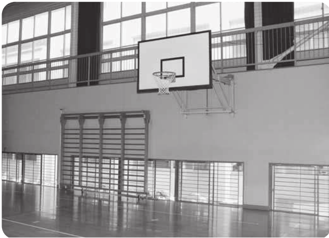
非構造部材の点検も早急に
