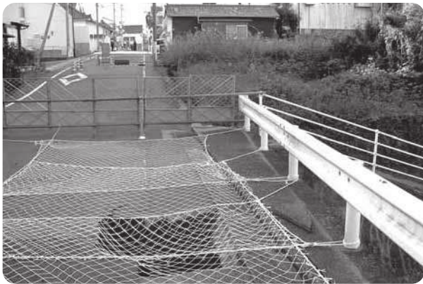
堀南浜線陥没事故
