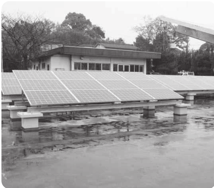
太陽光発電システム（小田城浄水場）
