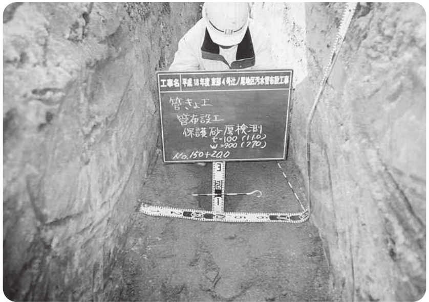
受益者負担の公平を（下水道整備）
