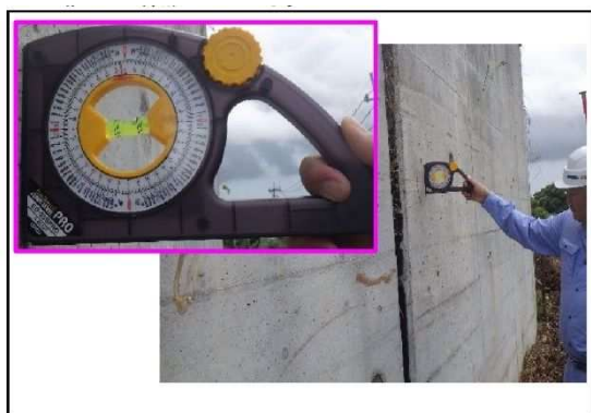
P14 鉄筋コンクリート擁壁。4.5° 前傾している。
