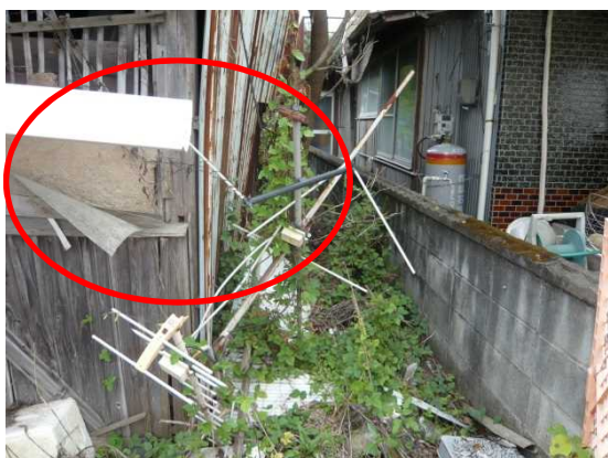
外壁材が剥がれている
