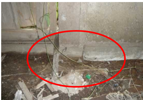
基礎、土台がずれている
