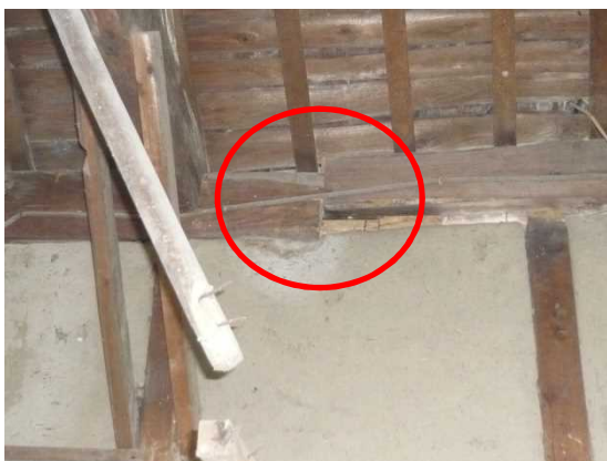
梁の接合部がずれている
