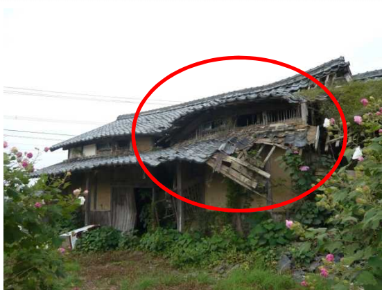
屋根が一部落下している
