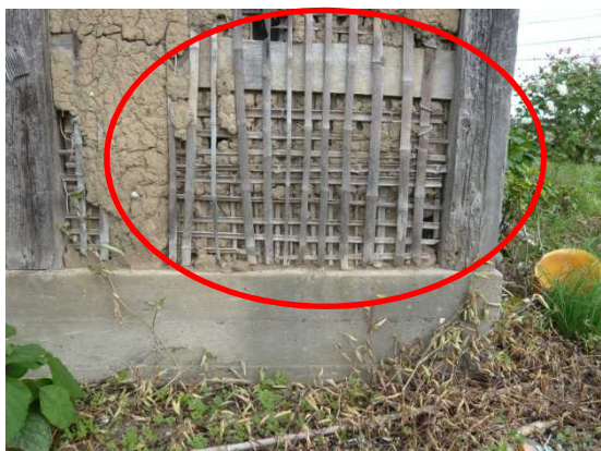
外壁材が剥がれて土壁が露出
