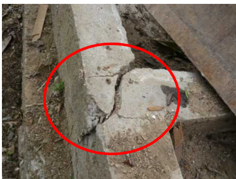
基礎がひび割れ、土台が無い
