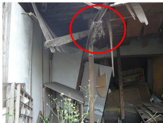
柱、梁が破損している
