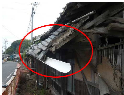
屋根、軒が垂れ下がっている
