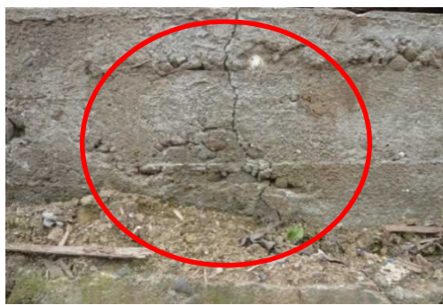
基礎にひび割れが発生している
