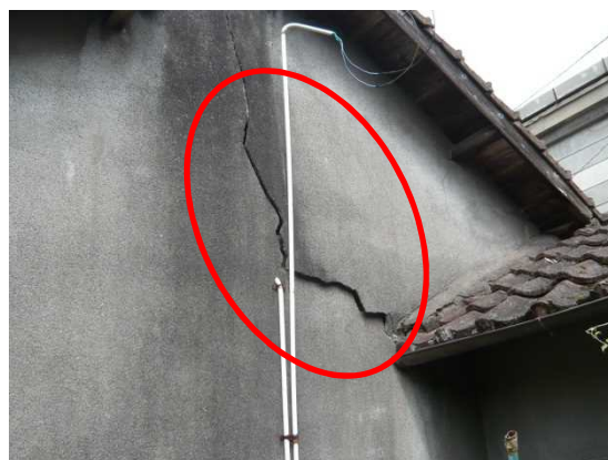
外装材にひび割れがある
