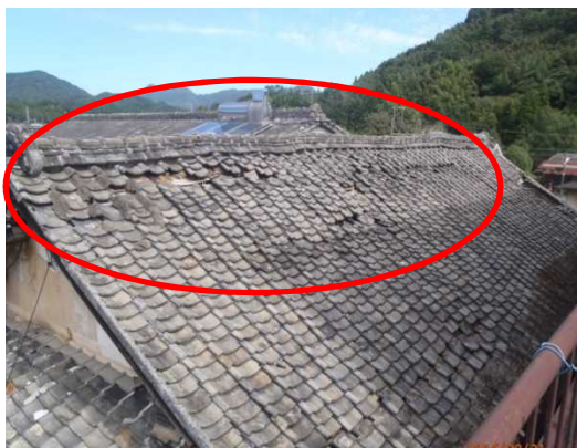
瓦が周囲に飛散する危険がある
