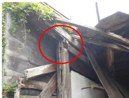
梁の腐食により欠損している
