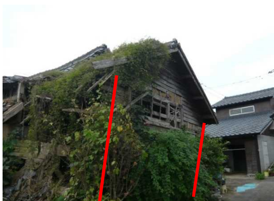
建物が傾斜し、道路に倒壊の危険
