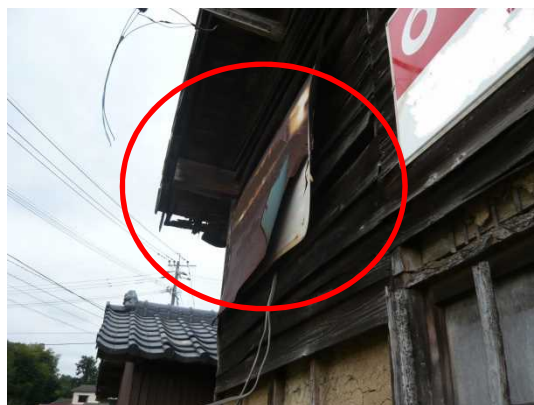
鉄製看板の落下の危険性
