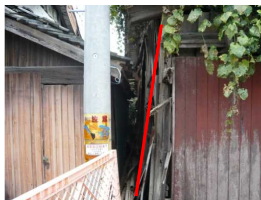
柱が傾斜している
