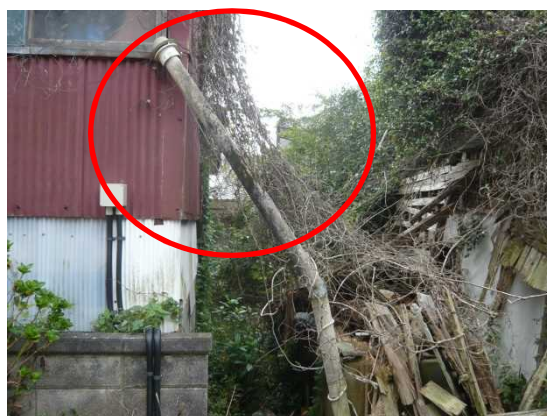
臭気筒が隣地へ倒れている
