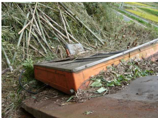
屋上給湯設備の落下
