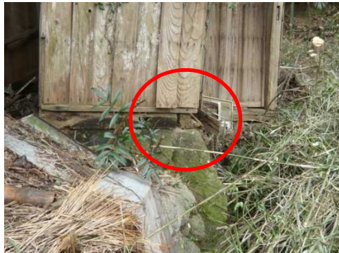
土台が腐朽して欠損している
