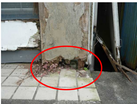
柱脚が腐朽し欠損している
