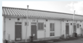
老朽化した町営青津山住宅
