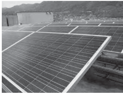
庁舎屋上の太陽光発電システム
