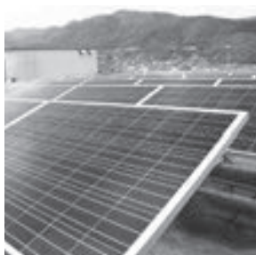
役場本庁舎や小田城浄水場に太陽光パネルを設置。豊岡小学校新校舎の屋根にも設置予定
