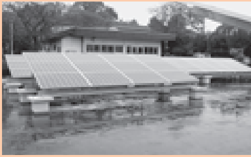
設置した太陽光パネル
