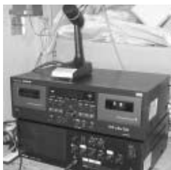
導入された放送設備
