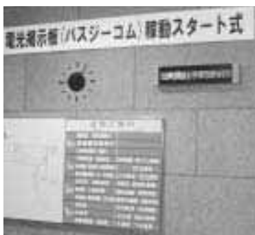
役場新館に設置された電光掲示板
